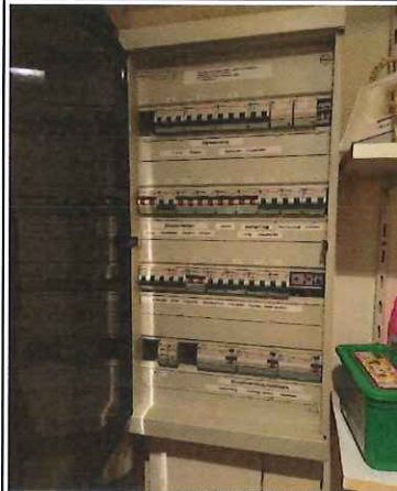
Foto 10: Afdekstrips zijn niet aanwezig in de zekeringskast, waardoor open delen zichtbaar zijn.
